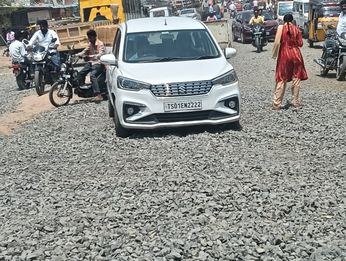
ఇచ్చోడ రోడ్డుపై గిట్టిలో కూరుకుపోయిన కారు, కాంట్రాక్టర్ నిర్లక్ష్యానికి పరాకాష్ట
